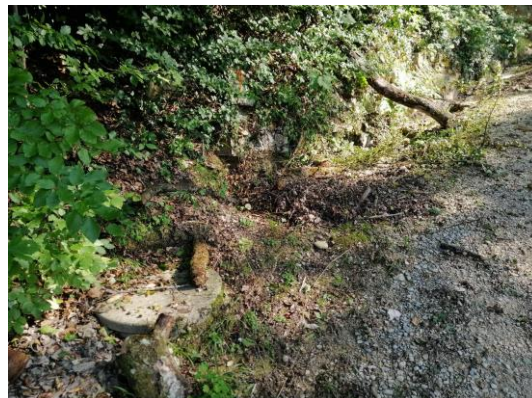
Verstopfter Einlaufschacht braucht dringenden Unterhalt
