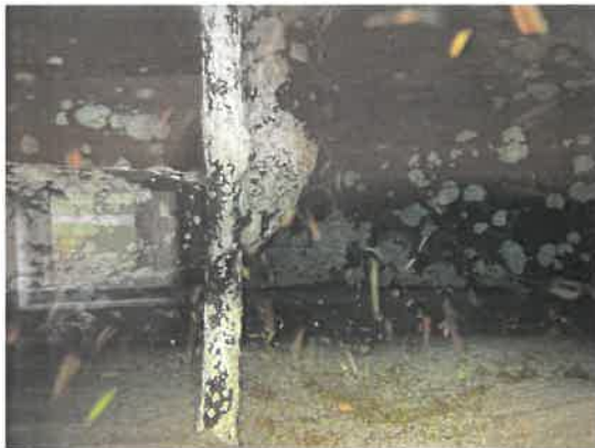
Bild 26: Drucksandfilter, Innenaufnahme: Einlauftrichter und Behälterwandung mit Korrosionsschäden.
