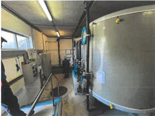
Bild 25: Drucksandfilteranlage nach über 50 Badesaisons am Ende der Nutzungsdauer mit ungenügender Umwälzleistung und massiven Korrosionsschäden.
