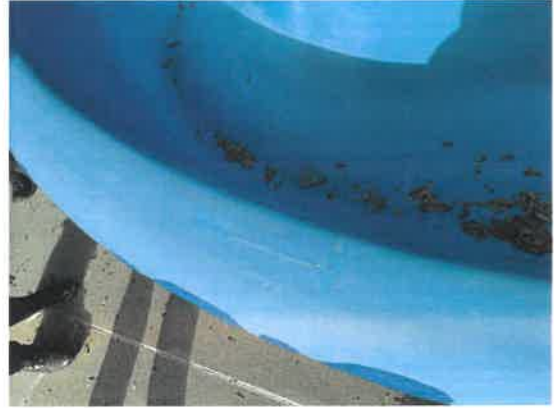
Bild 16: GFK-Material spröde und brüchig, verletzungsgefährlich.
