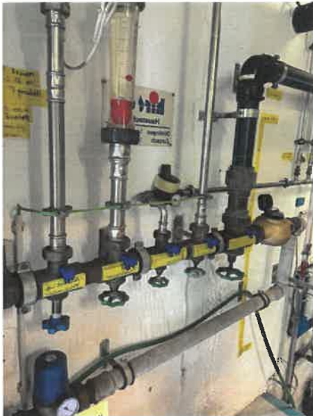
Bild 4: Netzwasserverteilerbatterie im Technikgebäude.
