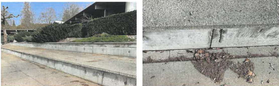
Bild 11+12: Liege- und Sitzflächen mit stark ausgesandeten Zementplatten, Winkелеlemente mit Abplatzungen und korrodierter Bewehrung.
