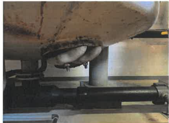
Bild 27: Drucksandfilter mit starken Korrosionsschäden, sowohl an den Aussen- als auch an den Innenflächen.
