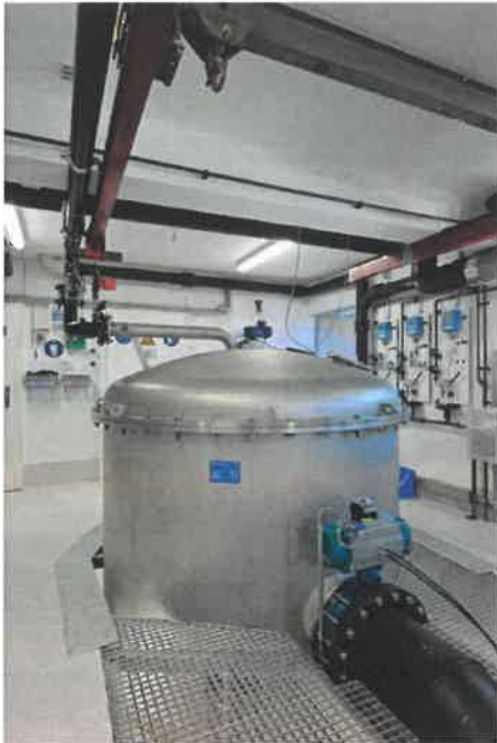
Bild 33: Anschwemmfilter Terrassenbad Baden. Baujahr 2017, Umwälzleistung 350 m 3 /h.
