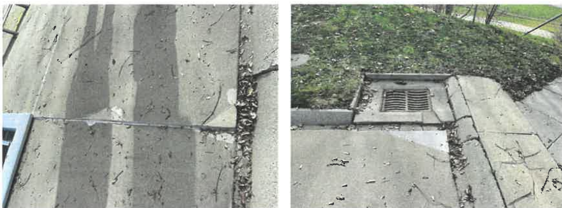
Bild 9+10: Betonierte Umgangsplatten mit Setzungen und Bruchstellen. Zerstörte Entwässerungsrinne.
