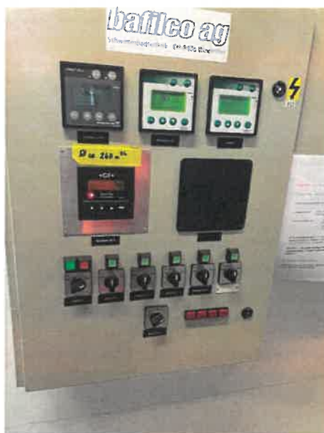
Bild 30: Steuerschrank für handbediente Anlage ist technisch veraltet.
