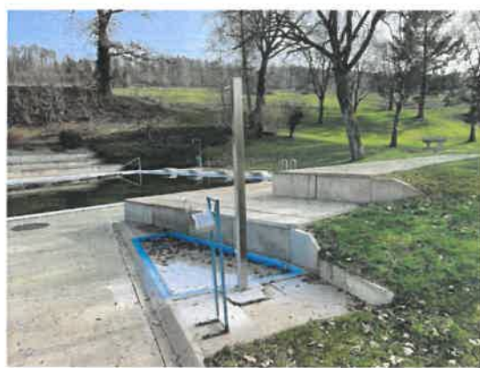
Bild 7: Dusche an ungünstigem Standort: Wasser spritzt auf den Sitz- und Liegebereich.
