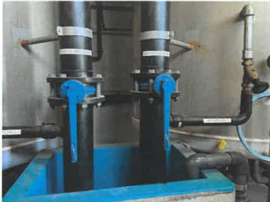
Bild 28: Armaturen für Handbedienung, nicht normenkonform, d. h. ohne Rückspülautomatik. Korrodierte Leitungen mussten durch PE-Leitungen ersetzt werden.
