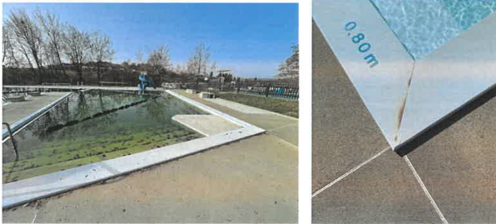
Bild 1+ 2: Die Delifol-Folie hat die prognostizierte Nutzungsdauer weit überschritten. Die Folie ist spröde, undicht und lässt sich nicht mehr reparieren.
