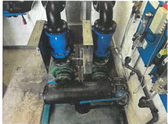
Bild 29: Filterpumpen aus Gusseisen am Ende der Nutzungsdauer, mit Korrosionsschäden, ungenügende Leistung und ineffiziente Motoren.
